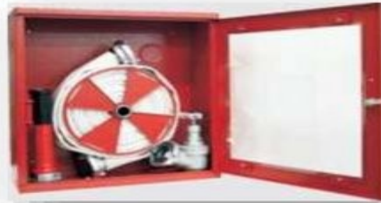
Hydrant v budove
