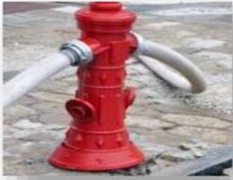
Hydrant na ulici
